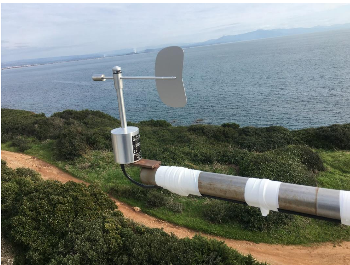
Εικόνα 1.2-3: Απο την αντικατάσταση ανεμοδείκτη στον σταθμό KTL-1 στις 22/12/2021.
